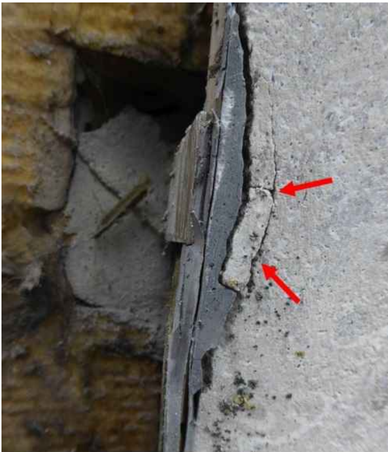
Steinausbruch am Ankerdorn
