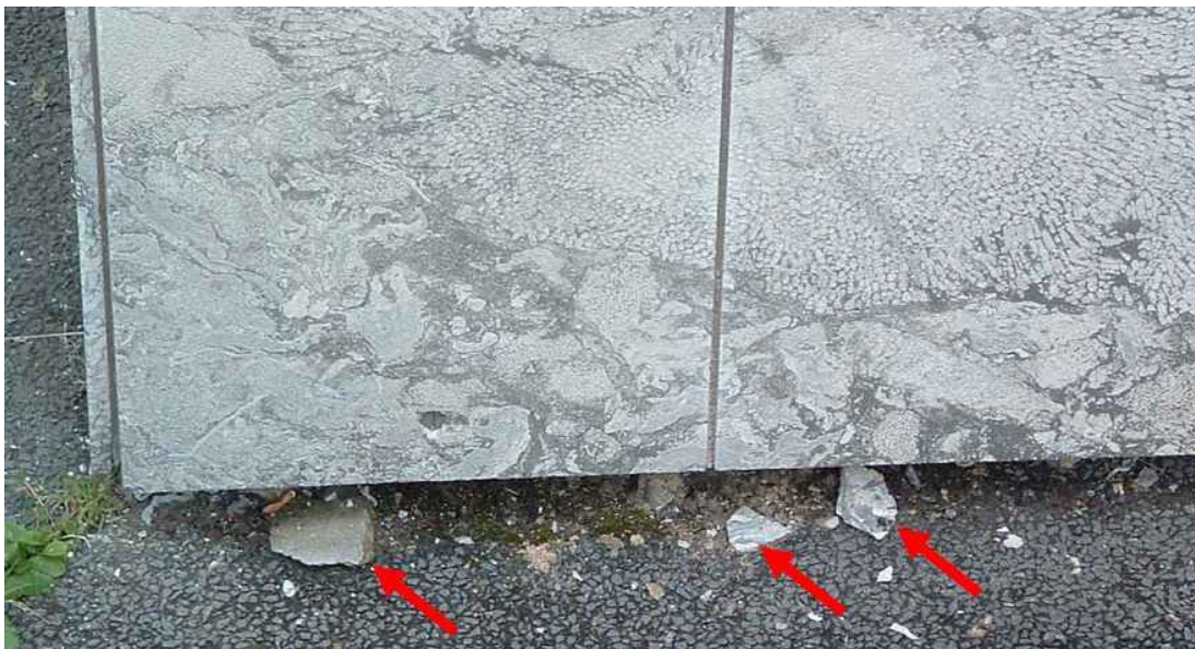
Steinsplitter, die von inneren Dornausbrüchen im Entlüftungsraum nach unten fallen.
