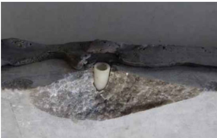
Am Befestigungsdorn ausgebrochener Stein
