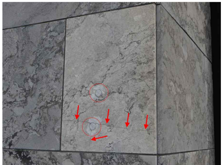
2 Nachverankerungen und 2 Risse
