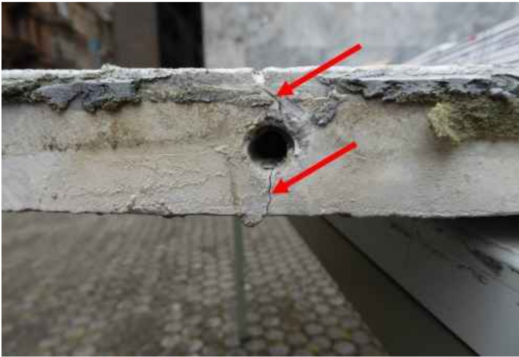
Dornankerloch mit Rissbildungen, die durch die Nachverankerung entstanden sind.
