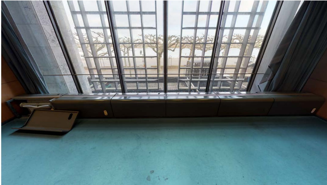
Abb. 27: Heizung am Wand Ost im Raum 00-93
