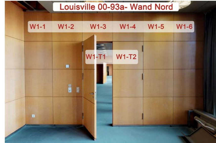
Abb. 4: Kennzeichnung Wand Nord
