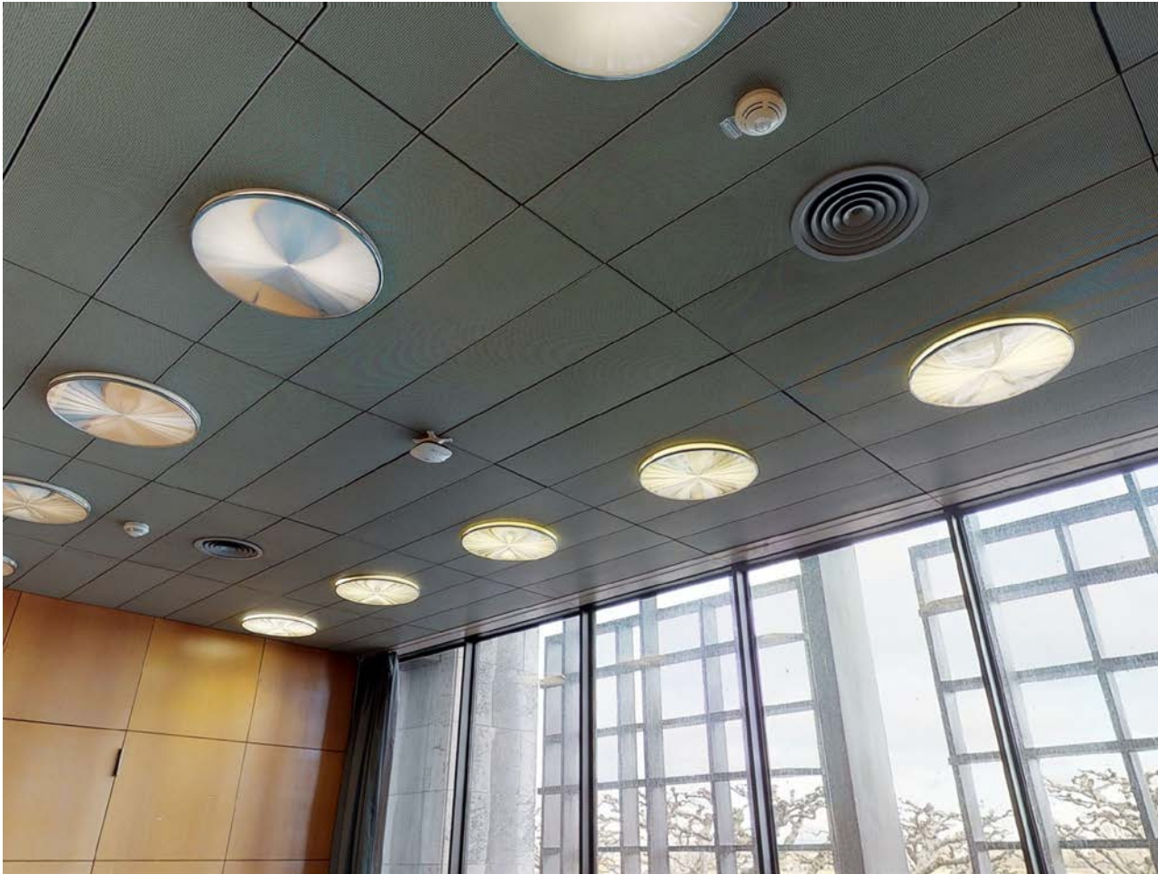
Abb. 24: Ansicht Decke und Leuchtensystem mit Abluftglocken im Raum 00-93
