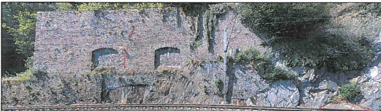
Detailfoto von Abschnitt D, gleisnahe Fangmauer mit geringer Rissbildung (links) und offene Felsbildung, ausbrechende Steine können an der linken Seite an der Mauer vorbei in das Gleis verspringen, rechts kleiner Schuttkegel direkt neben dem Gleis
