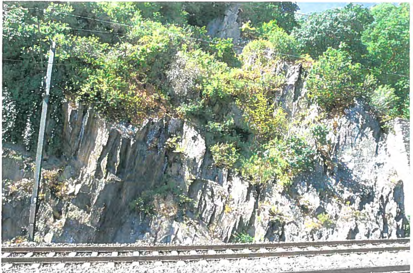
Detailfoto aus Abschnitt F bei Mast 134 - 24, gleisnahe, ungesicherte, offene Felsbildung, ausbrechende Steinen fallen direkt in das Gleis
