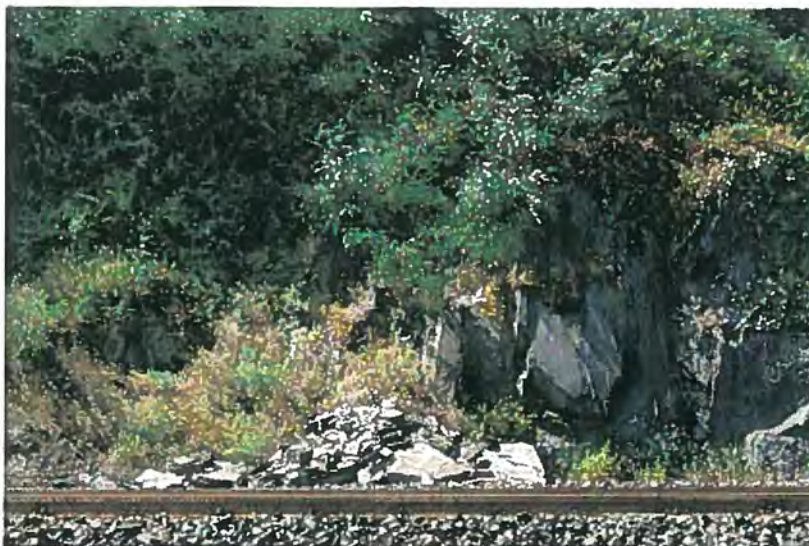
Detailfoto aus Abschnitt G, gleisnah befindet sich eine Schuttkegel, aus den Felsböschungen ausbrechende Steine können aufgrund des geringen Abstandes zwischen den Gleisanlagen und dem Hangfuß in das Gleis verspringen
