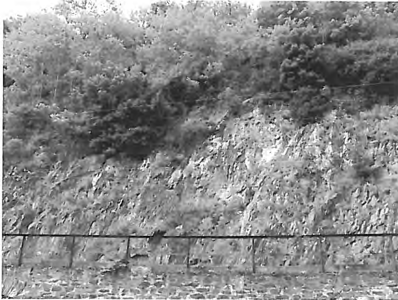
Abbildung 8: Felswand im Bereich der geplanten Netzfläche 1 und des geplanten Fangzauns 3 im Hangenden der bis zu ca. 80° steilen teilweise entfestigten Felswand
