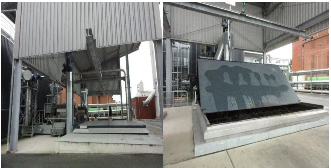
Abbildung 5-2: Beispiel einer Annahmestation / -bunker einer Klärschlamm-trocknungsanlage. Quelle: Betriebsbeschreibung der KOCKS CONSULT GMBH.
