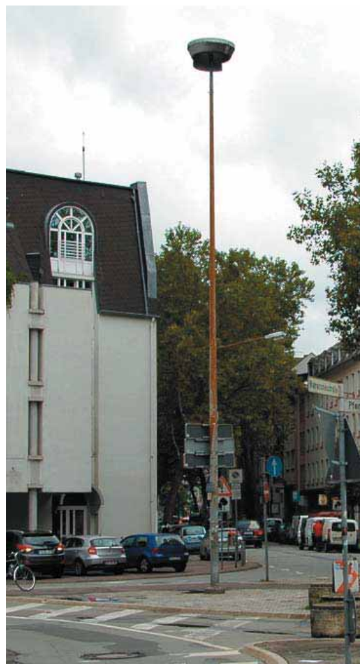
Bsp. stark korrodierter Leuchtenmast Bruchhausenstr.
