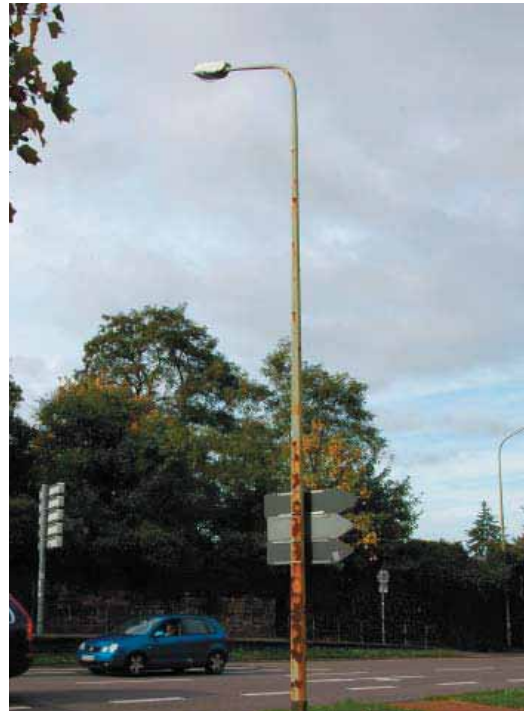
Beispiel stark korrodierter Leuchtenmast
