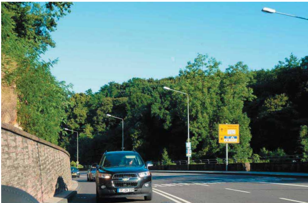
Bitburger Straße: Kofferleuchten an Mast mit Standardausleger
