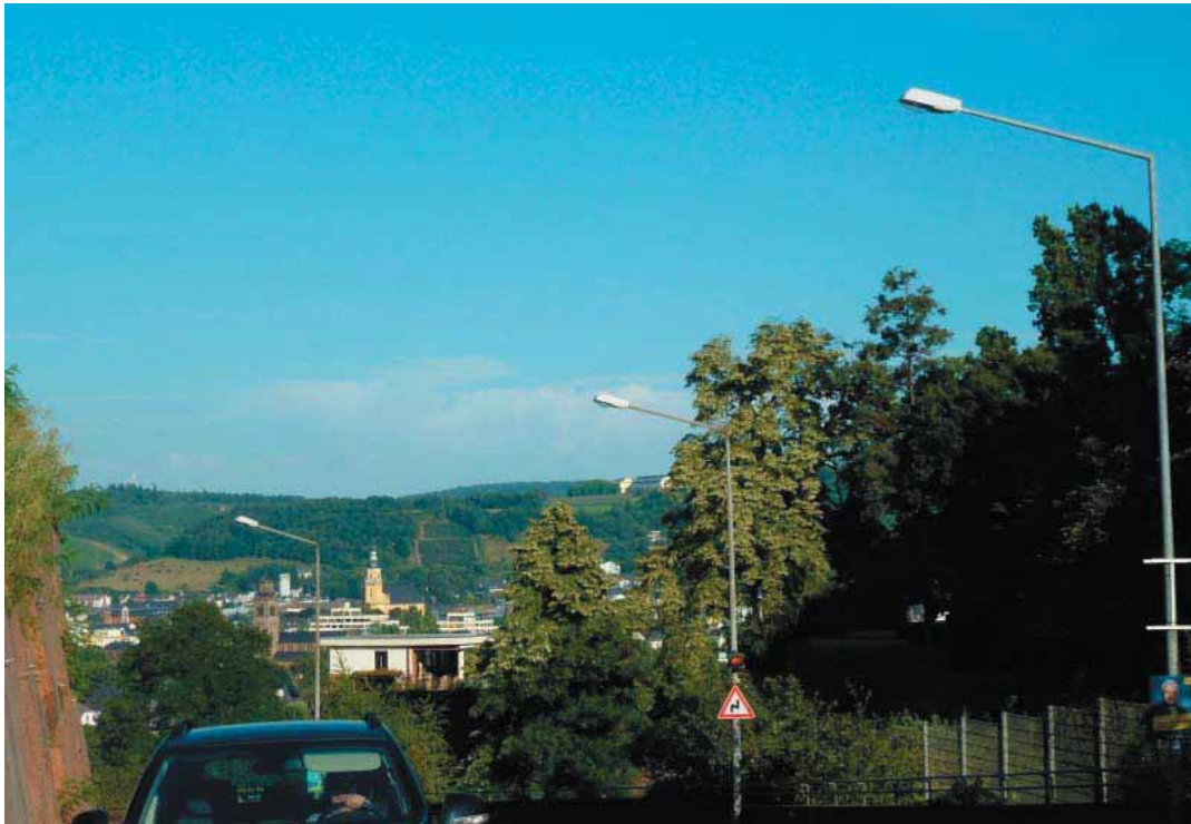
Bitburger Straße: Kofferleuchten an Mast mit Standardausleger
