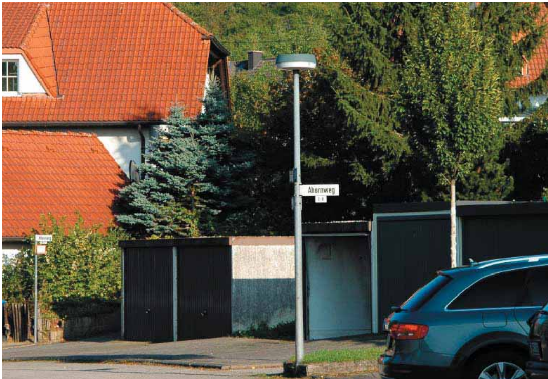
Ahornweg: Mastleuchte HQL
