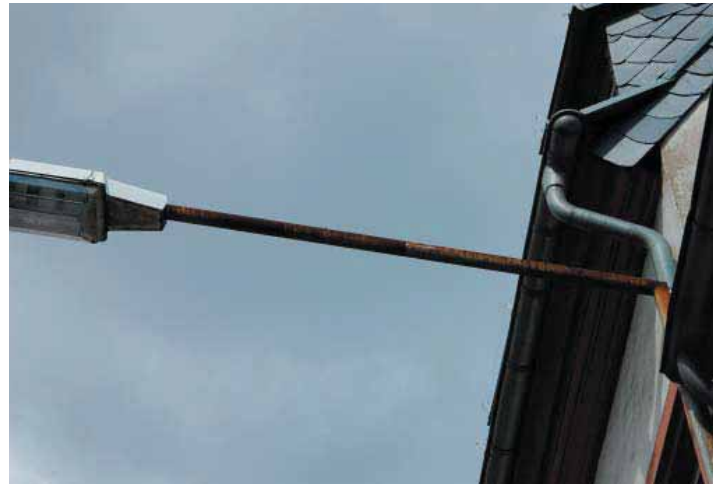
Beispiel stark korrodierter Leuchtenmast
