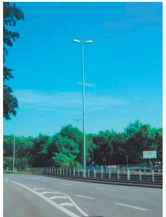
Bestand Beleuchtungsanlagen Kaiserthermenkreisverkehr
