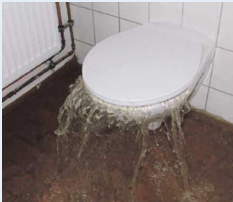
Überlaufende Toilette durch Kanalrückstau. Foto: THW
