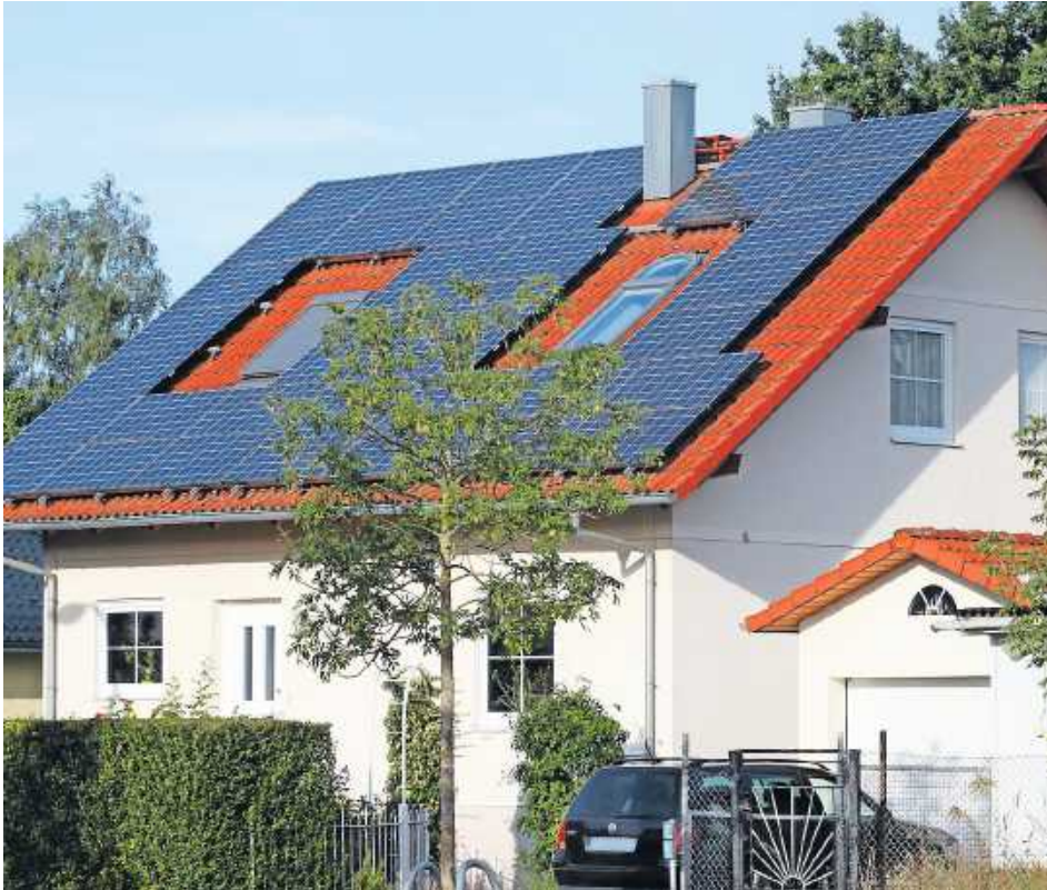
Im Schnitt wird rund ein Drittel des Stroms der Photovoltaikanlage auf dem Hausdach auch im Haushalt verbraucht.
