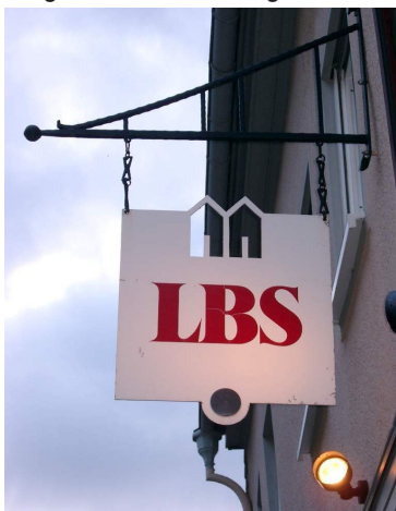
Kleiner Einzelstrahler zur Beleuchtung der Werbeanlage
