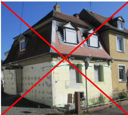
Unpassende Wärmedämmung an historischem Gebäude
