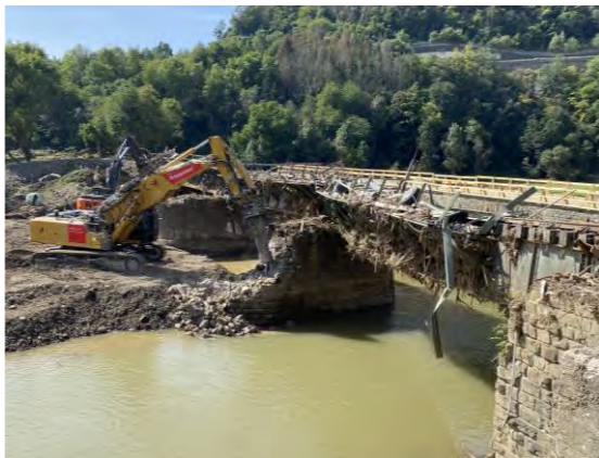
Sturmtief Bernd zerstört Brücken, Bahndämme, Oberbau, Bahnhöfe und weitere Infrastruktur entlang der Ahrtalbahn
