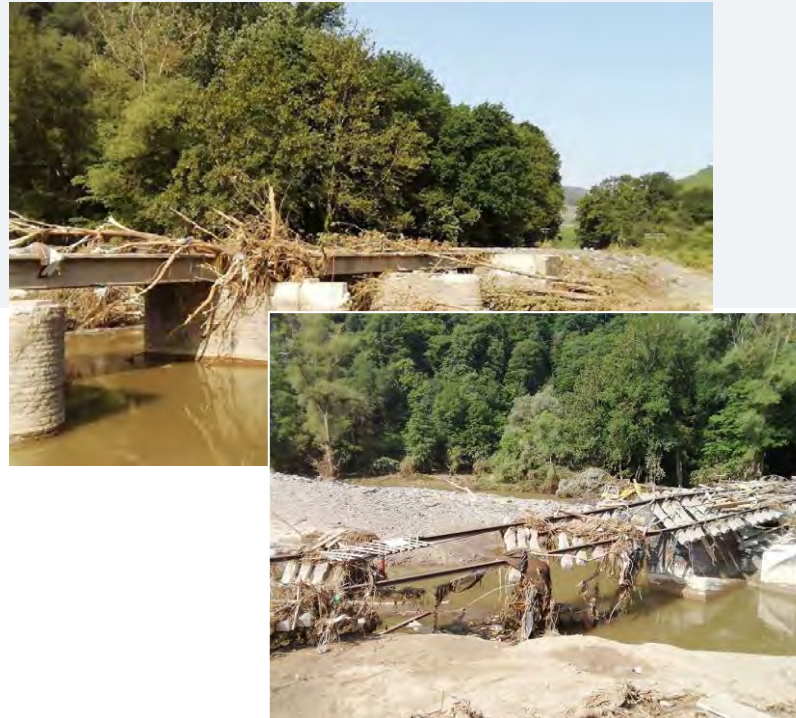
8 Brücken sind auf der Strecke zerstört
