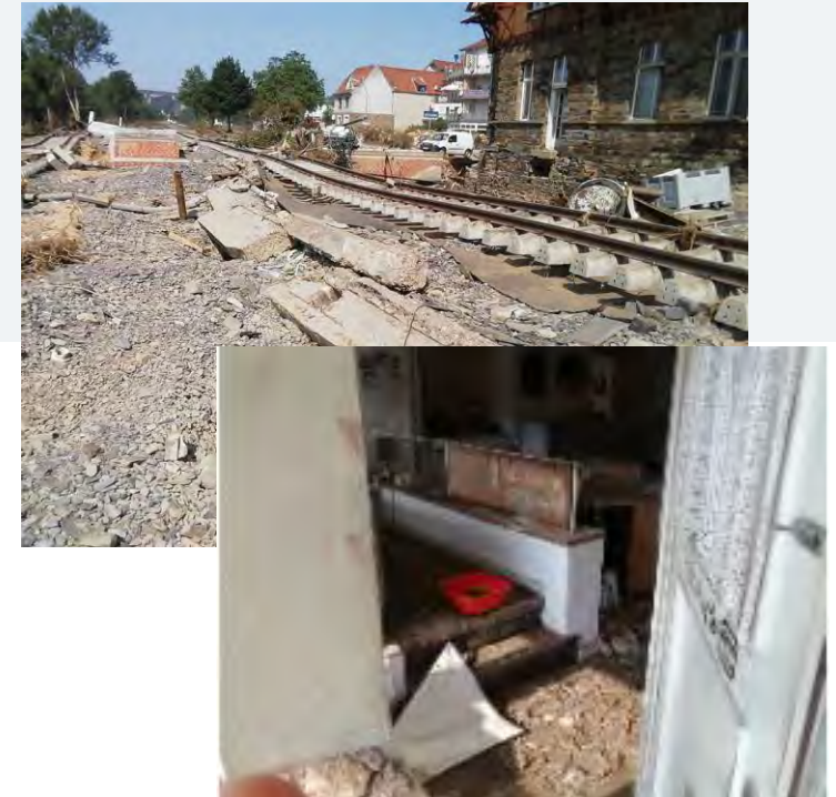
Die Alt-Stellwerke und das bereits in Bau befindliche ESTW Ahrtalbahn wurden zerstört
