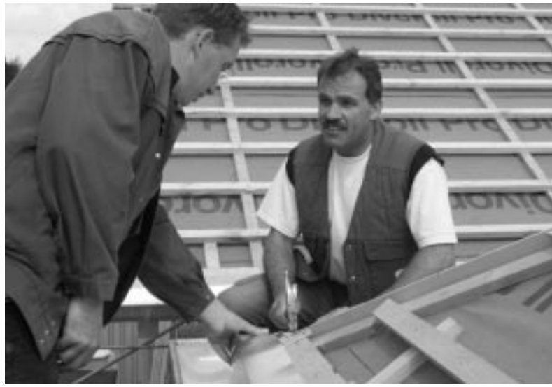
Auf den Dächern zu Hause: Kreishandwerksmeister Kurt Krautscheid (r.) mit seinem Meister Christian Schulte auf einer Baustelle vor Ort. Foto: Gaida
