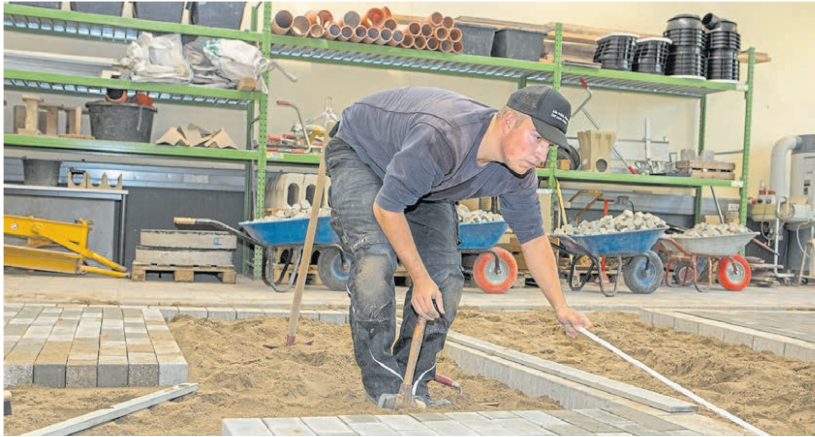
Marius Faller fuhr mit einer Spitzenleistung am 11. November den Bundessieg im Straßenbauerhandwerk ein. Ausgebildet wurde der 19-Jährige in Idar-Oberstein. (Das Bild entstand beim Landesentscheid in Rheinland-Pfalz).
