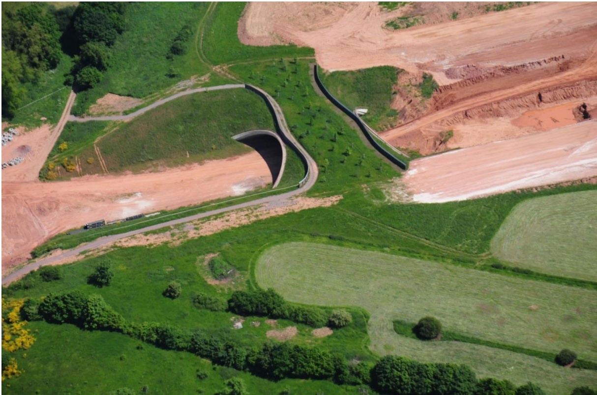
Abb. 9: Die Grünbrücke Haardter Weiher bei Altrich (B50 Mosel) wurde im September 2013 schon fertiggestellt und bepflanzt, während die Trasse erst hergestellt wird.
