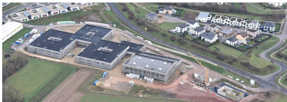
Das Luftbild zeigt den aktuellen Stand des Bauprojektes - auf der Fläche rechts unten im Bild entsteht die Eisspeicherheizung. Foto: portaflug
