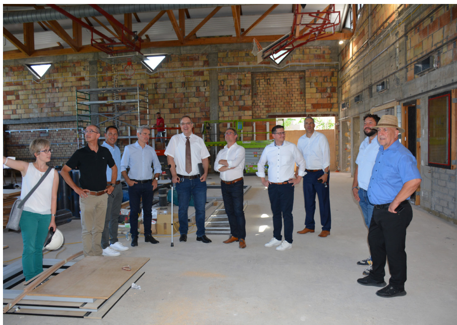
Die Verantwortlichen informierten sich im Schulzentrum Konz über den Stand der Sanierungsarbeiten - hier in der Sport- und Mehrzweckhalle.
