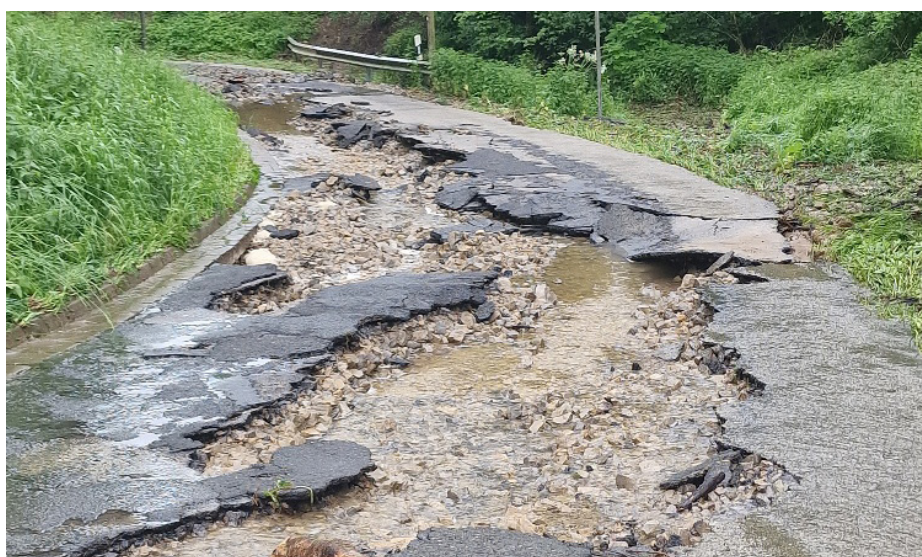
Diese Schäden an der Kreisstraße 7 bei Udelfangen sind durch an Unwetter an Pfingsten entstanden.
