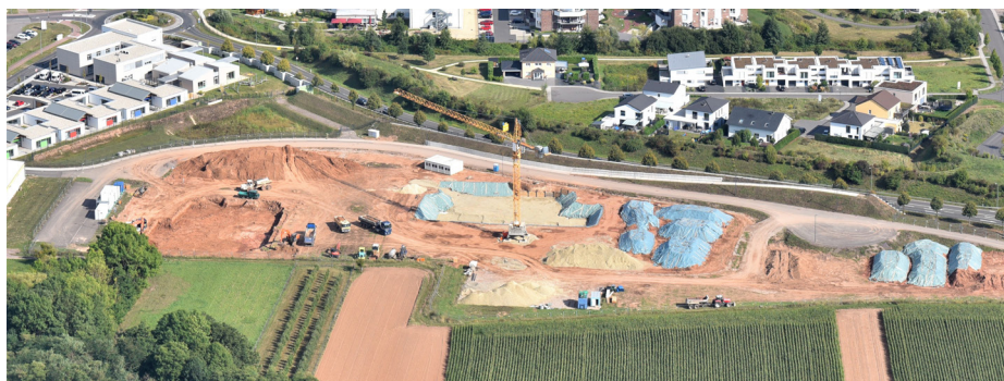
Wie alles begann: Das Foto zeigt die riesige Baugrube beim Start der umfangreichen Bauarbeiten im Jahr 2019.
