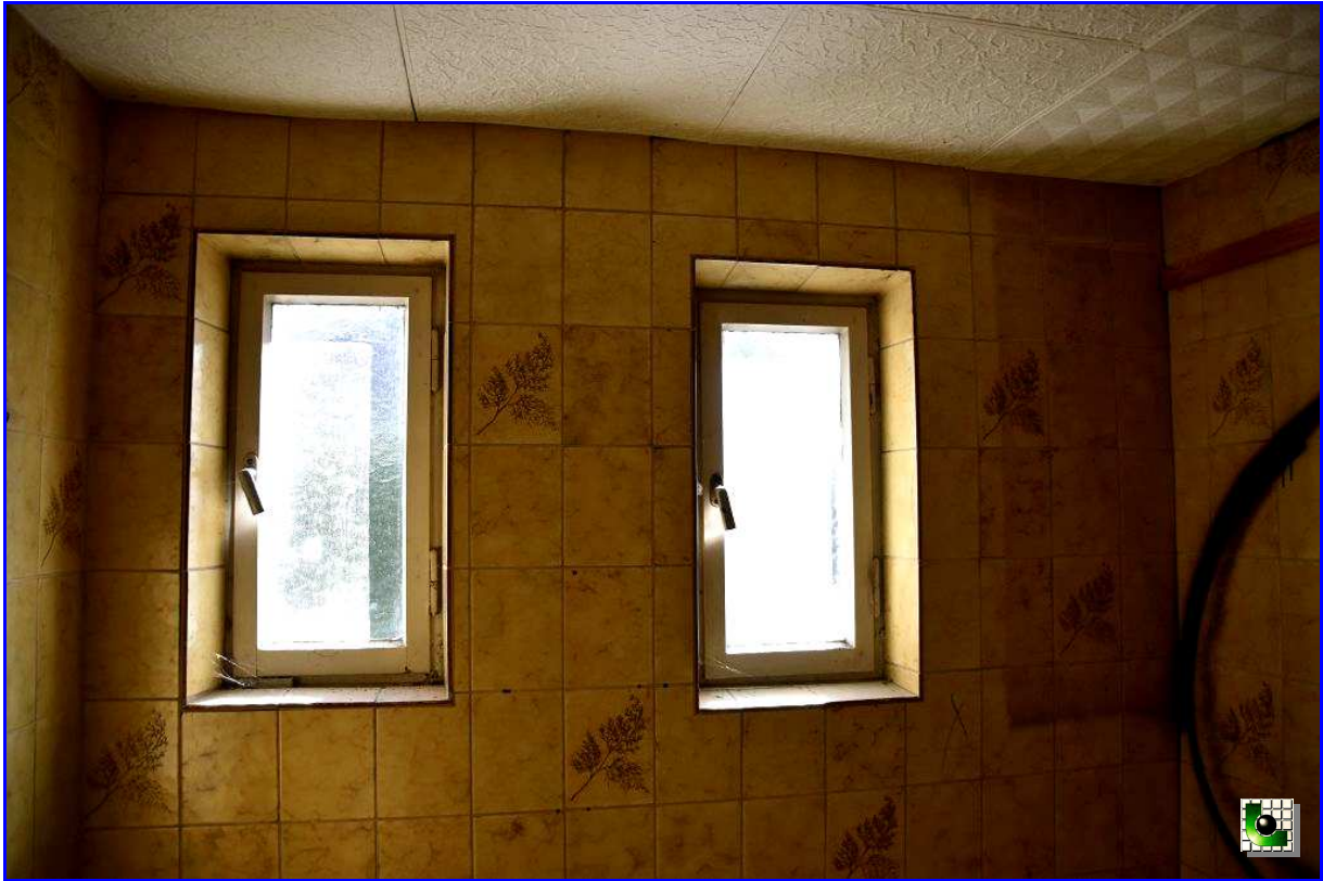
Abb. 10: Sanitärebereich im 1. OG
