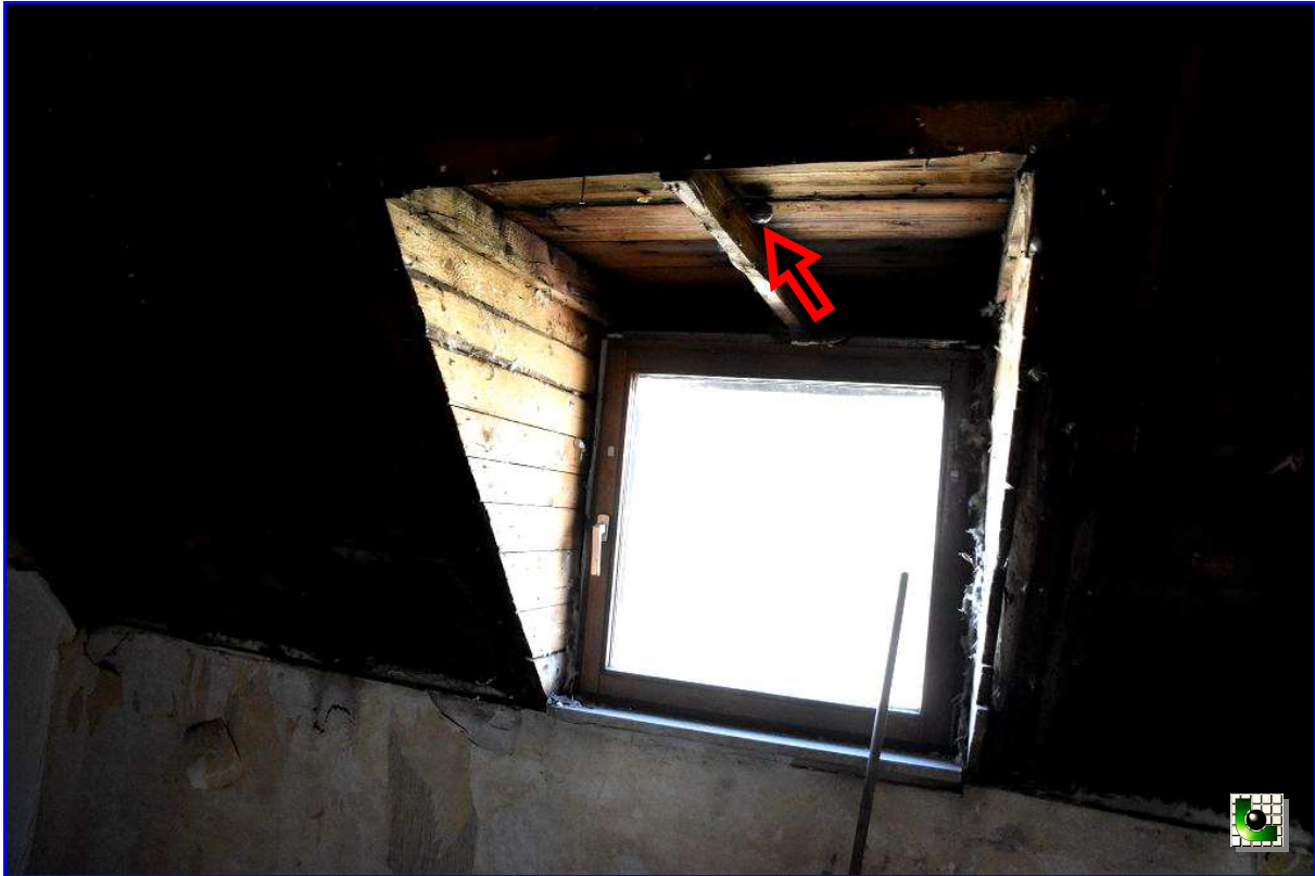
Abb. 12: Ungedämmtes DG, hier mit verlassenen Wespennest (vgl. Pfeilsignatur)
