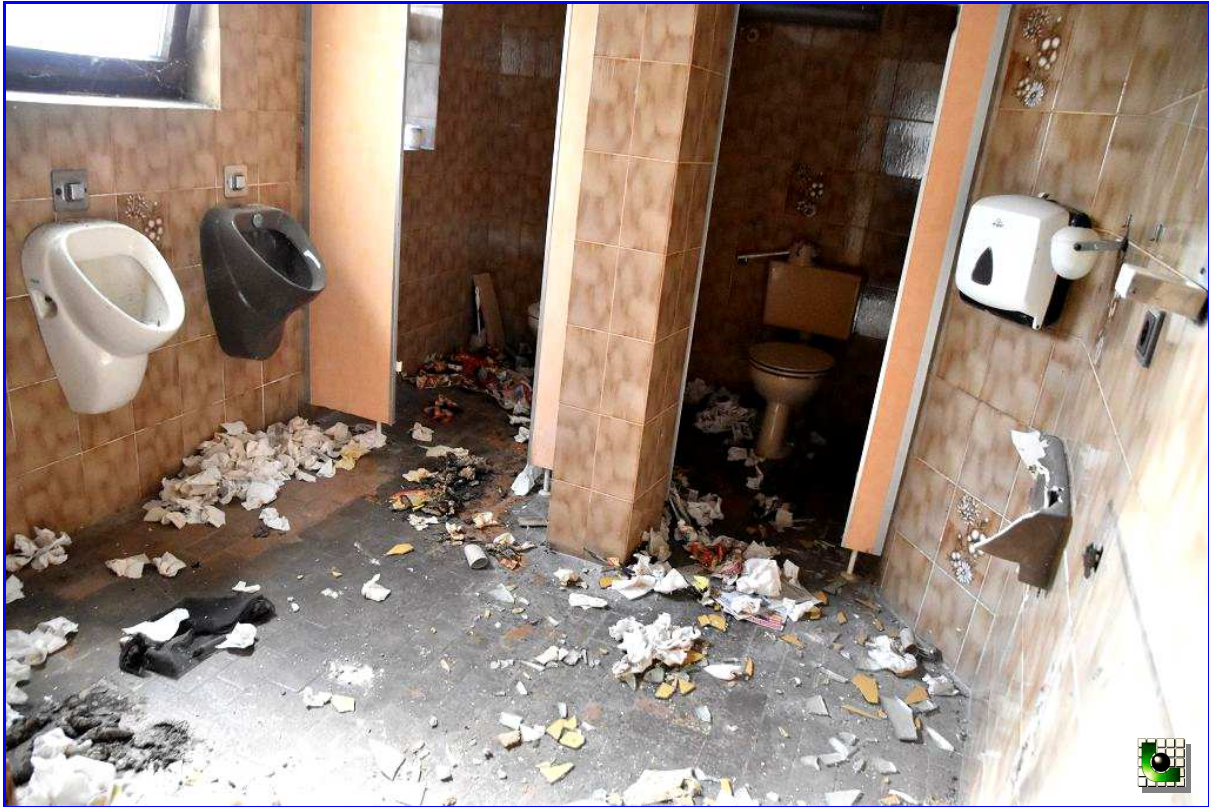
Abb. 8: Sanitärbereich im EG mit Vandalismusschäden
