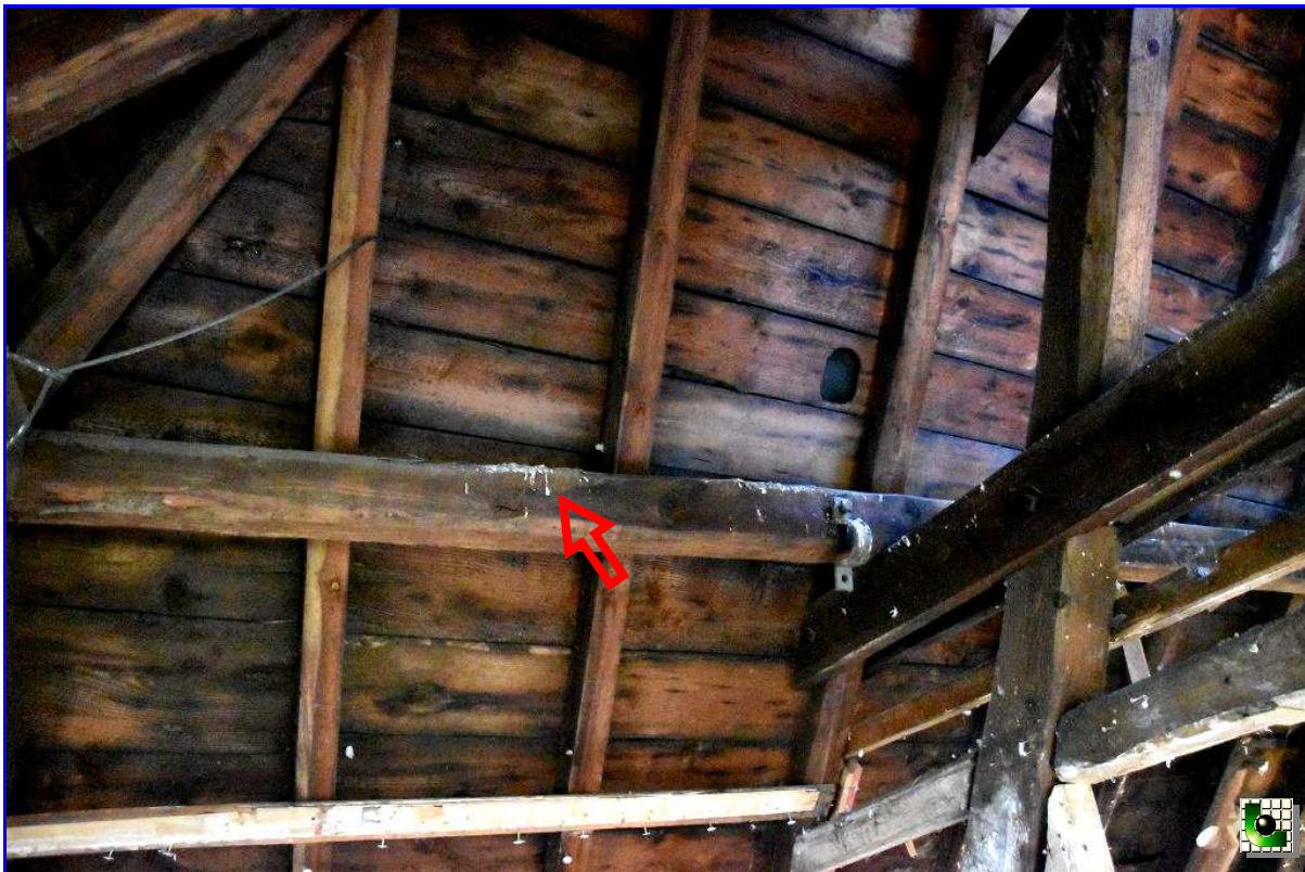
Abb. 13: Dachgebälk mit Kot der Straßentaube
