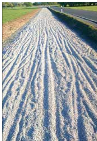
Deckschicht durch unerlaubte zu fruhe Nutzung vollig zerstort
