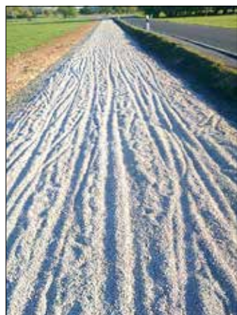
Deckschicht durch unerlaubte zu frühe Nutzung völlig zerstört
