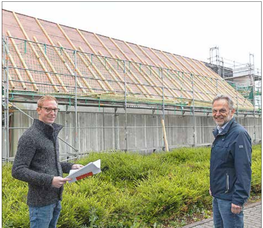
Nach Beginn der Bauarbeiten an der Dachsanierung der Großen Sporthalle im Schulzentrum informierten sich Bürgermeister Andreas Heidrich (rechts) und sein Mitarbeiter Mirco Benner vom Bauamt der Verbandsgemeindeverwaltung vor Ort über die bisher erfolgten Arbeiten. Foto: Röder-Moldenhauer
