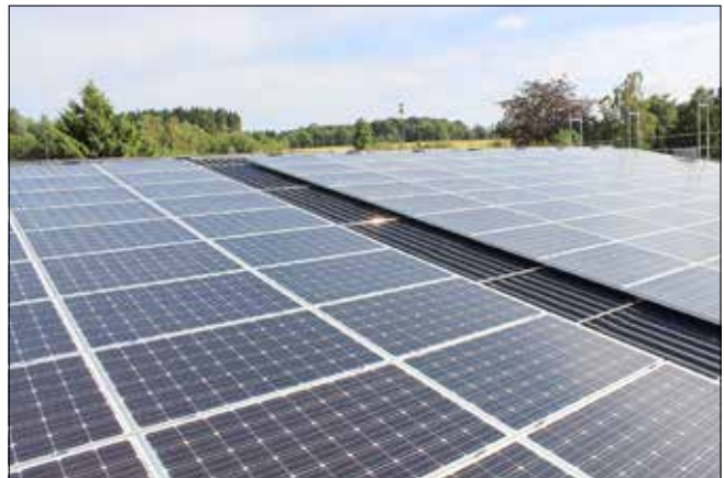
Photovoltaik-Anlage auf dem Dach der Kleinen Sporthalle im Schulzentrum Bad Marienberg. Foto: Klaus Müller
