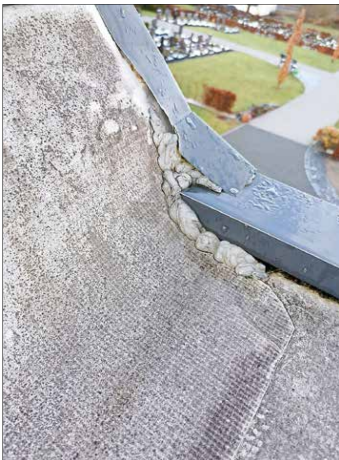
Vorgefundene „Silikonwurste“ als Reparaturlosung (?)
