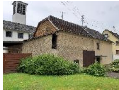
historisches (Neben-) Gebäude mit Putzfassade, Krüppelwalmdach, Natursteingiebel und Sanierungsbedarf
