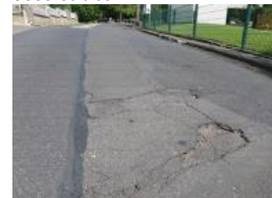
Am Telegraphenberg - Straßenschäden
