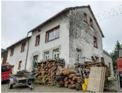
historisches Gebäude mit Putzfassade, Sprossenfenstern im Erdgeschoss und Sanierungsbedarf
