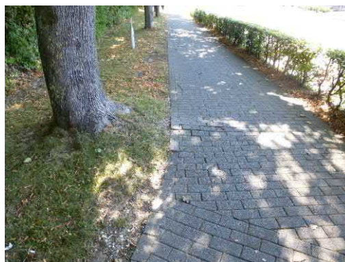
Abbildung 34: Bitburg, Saarstraße - schmaler Fuß- und Radweg mit Wurzelaufbrüchen
