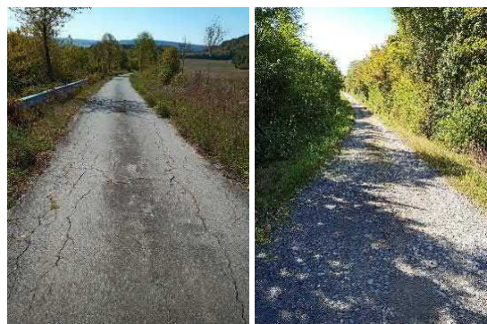
Abbildung 95: Extrem schlechte Beläge der Wirtschaftswege auf beiden Seiten der B 257
