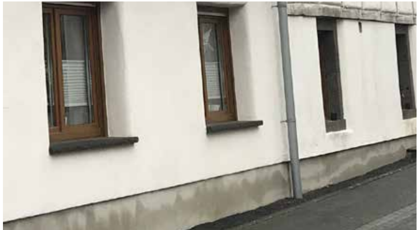
Modernisierungs- und Instandsetzungsbedürftiges Gebäude mit geringem Bedarf
