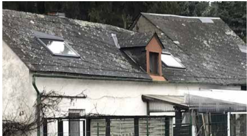
Modernisierungs- und instandsetzungsbedürftiges Gebäude mit hohem Bedarf
