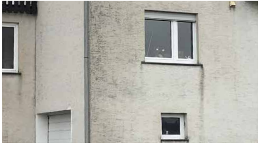
Modernisierungs- und Instandsetzungsbedürftiges Gebäude mit mittlerem Bedarf
