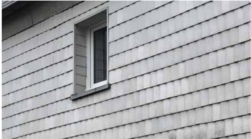
Misstand: Materialität der Fassade
