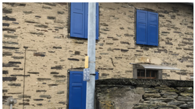
aufdringliche Farbgebung (Fensterrahmen, Klappläden)
