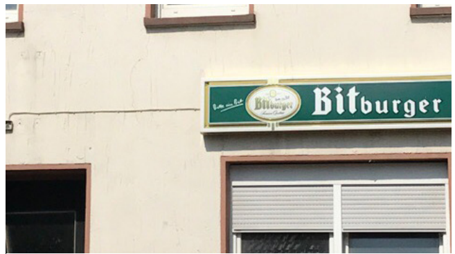
Negativ: Werbeanlagen mit offenliegenden Kabeln
