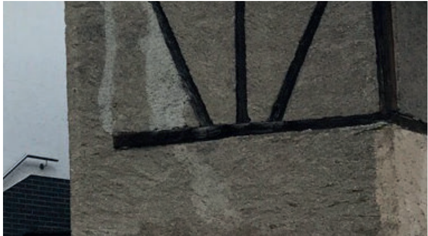
Modernisierungs- und Instandsetzungsbedürftiges Gebäude mit mittlerem Bedarf
