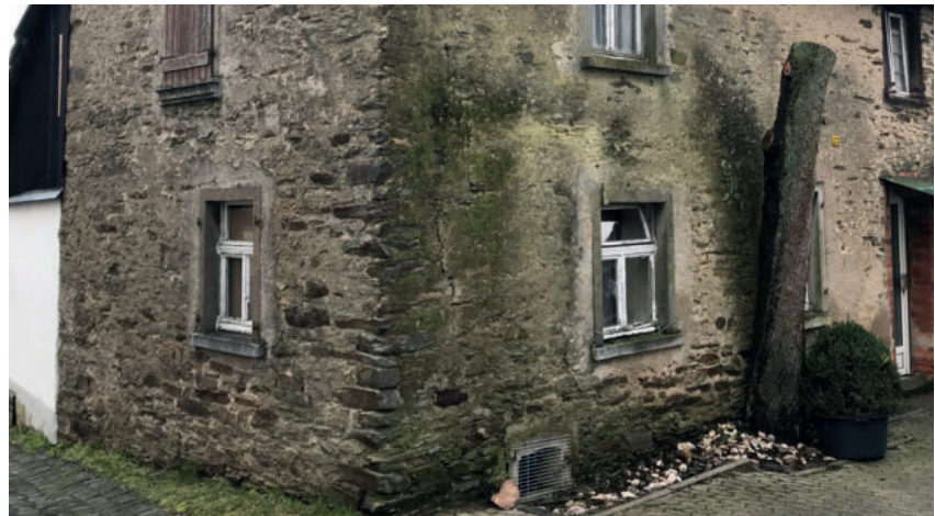
Modernisierungs- und instandsetzungsbedürftiges Gebäude mit hohem Bedarf
