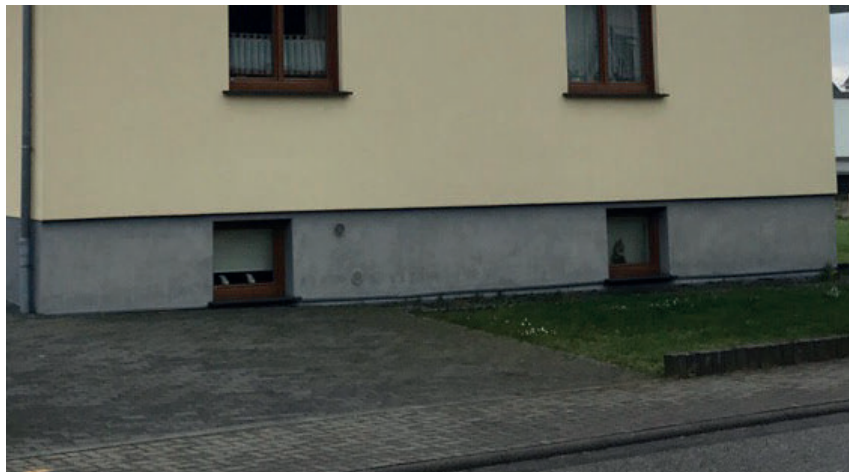
Modernisierungs- und Instandsetzungsbedürftiges Gebäude mit geringem Bedarf
