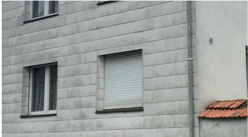
Misstand: Materialität der Fassade
