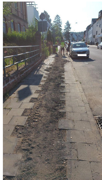
Abbildung 4: Mit Schotter prov. verschlossener Graben in einer Plattenfläche
