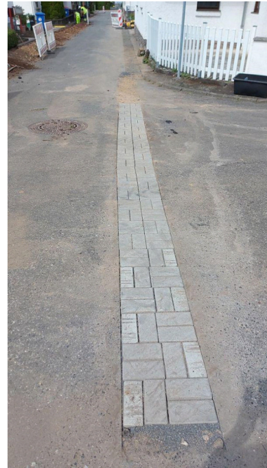
Abbildung 2: Mit Pflastersteinen prov. verschlossene Asphaltquerung
