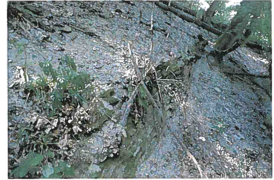
Detailfoto aus Abschnitt B, Natursteinmauer in Trockenbauweise aus Schiefer, Hinterfüllraum ist überfüllt, Schuttmaterial kann über die Mauer hangabwärts rutschen, die Mauer zeigt deutliche Ausbauchungen und Risse, sie ist visuell in einem sehr schlechten Zustand
