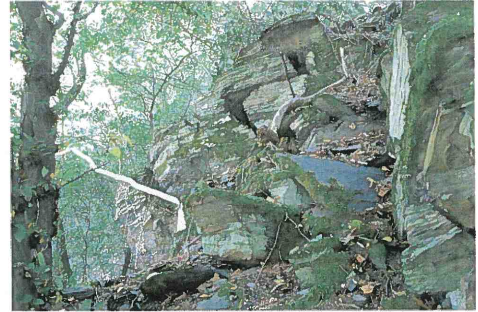
Detailfoto aus Abschnitt B, offene Felsbildung mit weit geöffneten Trennflächen, Öffnung der Trennflächen wird durch Wurzeldruck noch verstärkt
