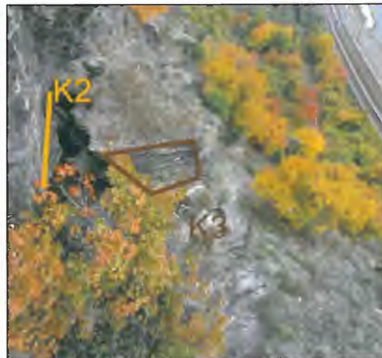
Detailfoto am Messpunkt 5. Blick auf K3 - Fläche, stark geöffnete K2 unterschneidet Block.
