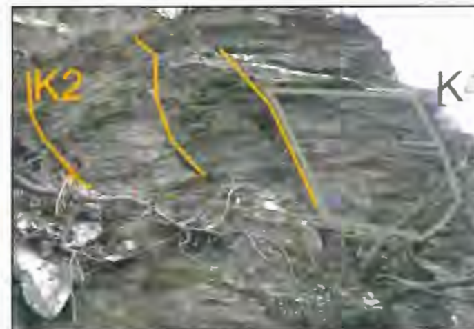
Detailfoto am Messpunkt 3, Blick auf die K4 Ebene mit mehreren, parallel verlaufenden K2 - Klüften.
