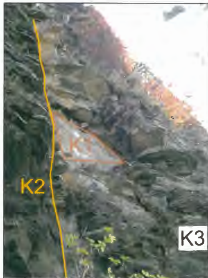
Detailfoto am Messpunkt 16: K1 verläuft böschungsparell, K2 und K3 verschneiden miteinander - kinematisch Gleiten möglich
