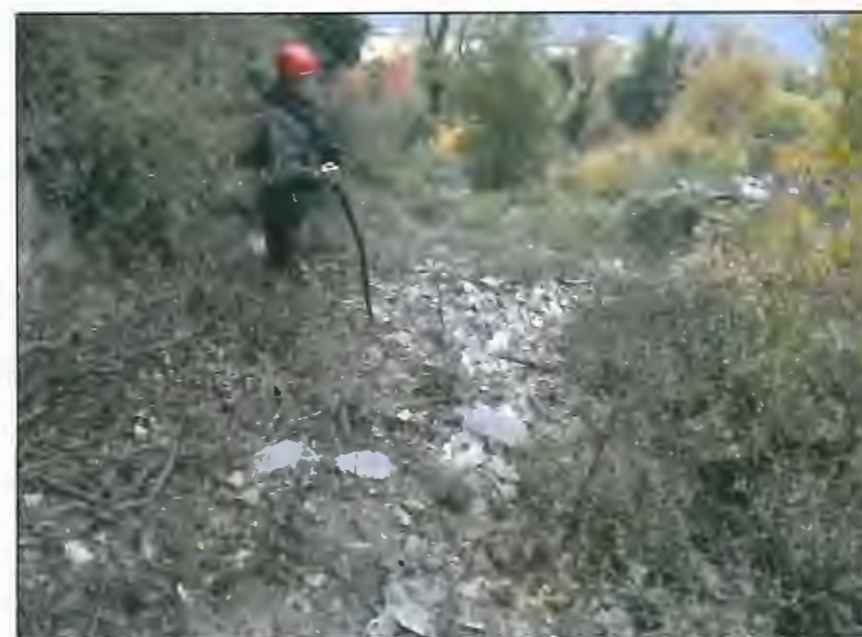
oben & links: Detailfotos am Übergang Felsböschung - Schuttrinne. Felsböschung: Verschneidungen K2-K3 - kinematisch Gleiten möglich
