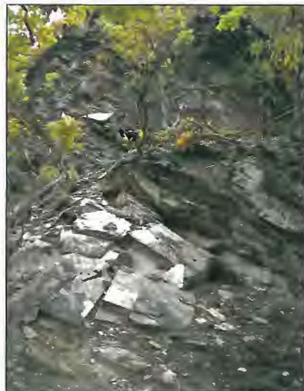
Detailfoto am Messpunkt 3, Schuttmassen im Hang.
