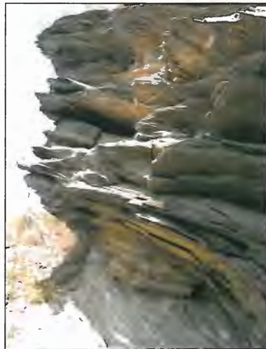
Detailfoto von Messpunkt 15: Hohlkehlbildung am Böschungsfuß; Ablösung von Gesteinsplatten auf Sch/S1 - "Schuttmassenlieferant"
