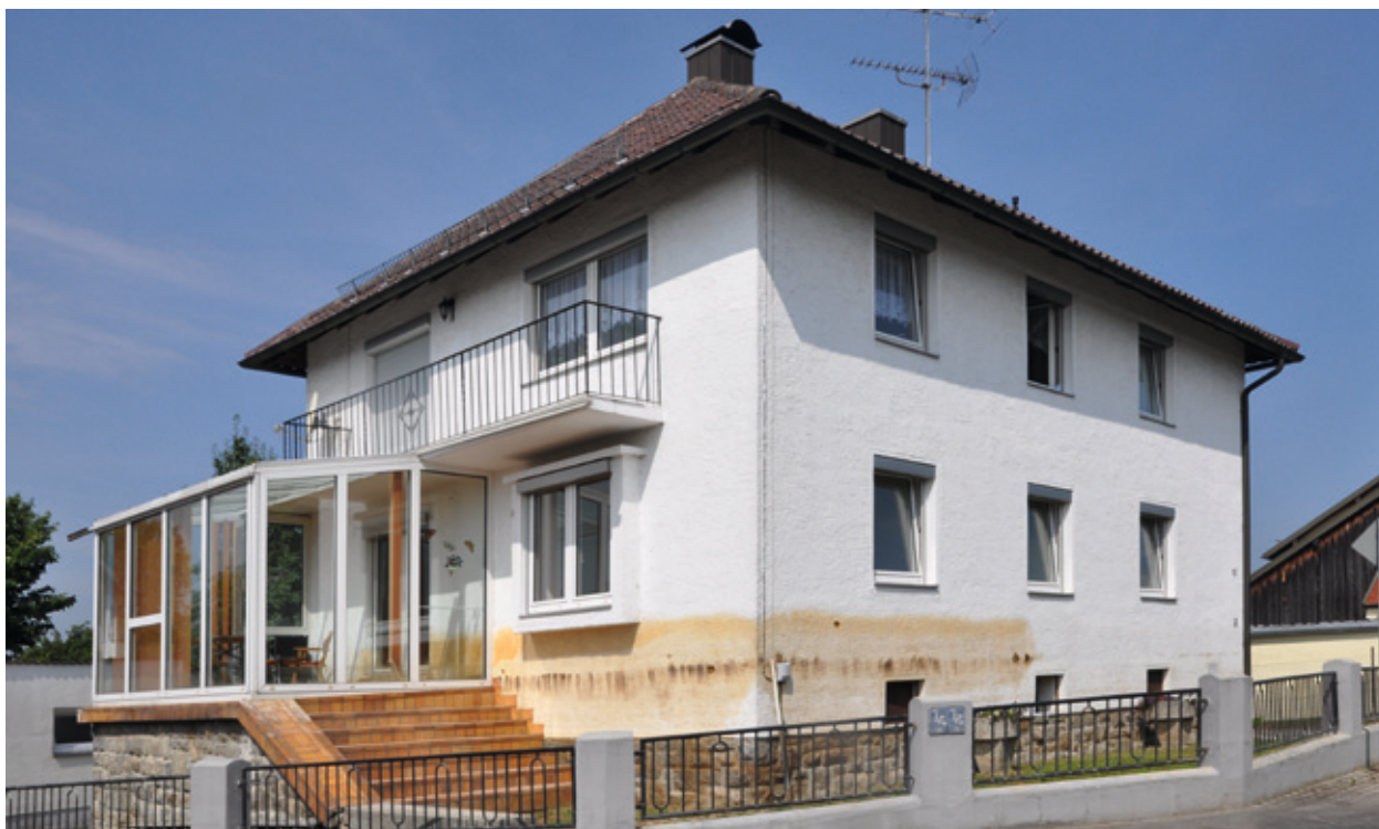
Mit Heizöl belastetes Wärmedämm-Verbundsystem eines Wohnhauses
