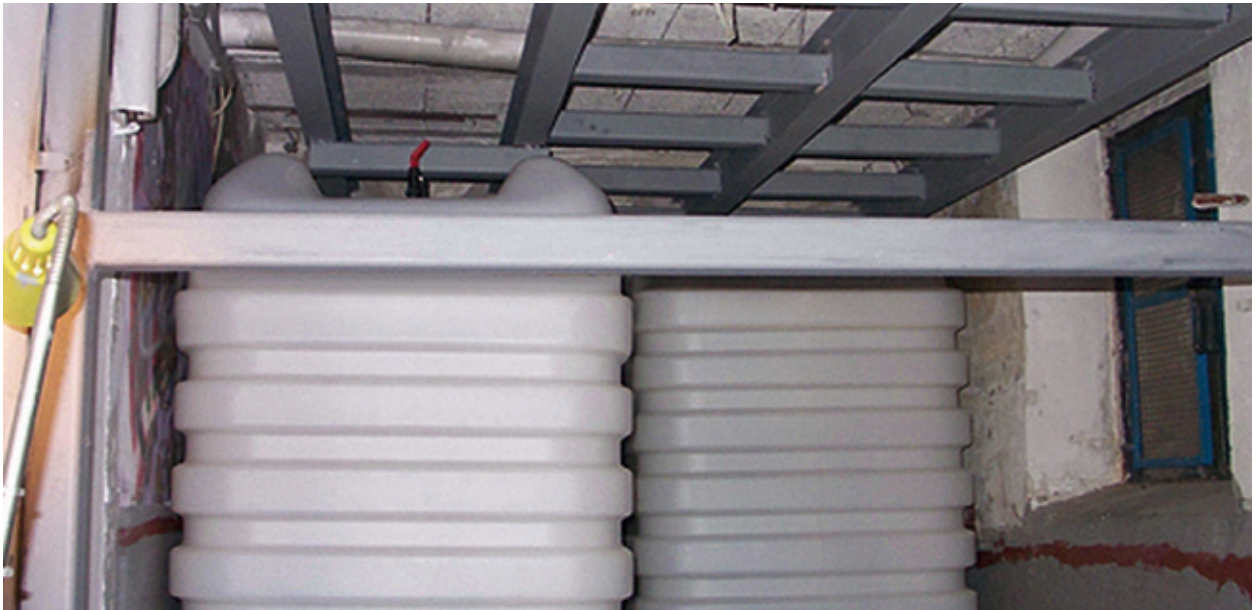
Heizöltankanlage mit Auftriebssicherung
