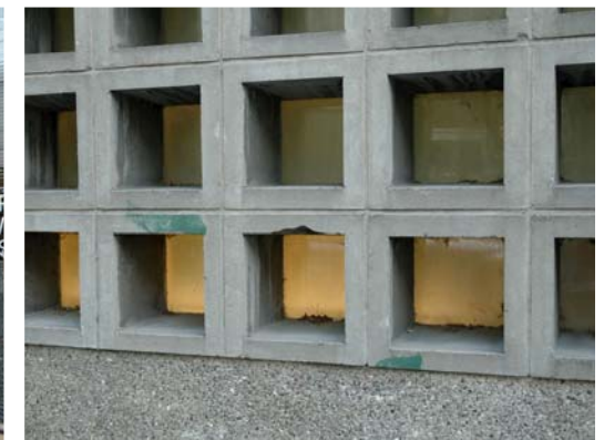
Bauliche Mängel Seilergasse
