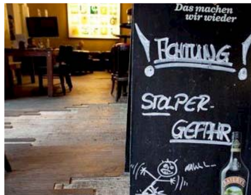
Cafe Codex, Boden in schlechtem Zustand
