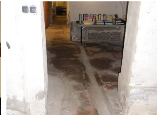
UG Römischer Kaiser, Feuchtigkeitsprobleme
