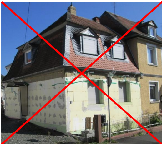
Unpassende Wärmedämmung an historischem Gebäude
