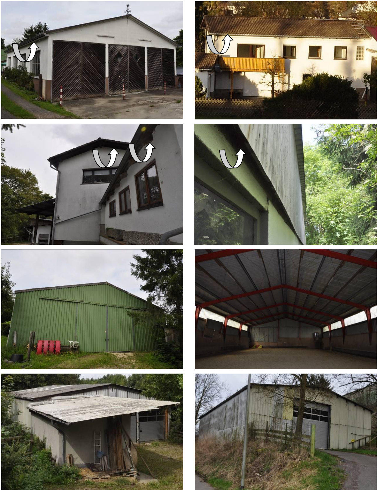
Abbildung 5: Beispiele von Spalten hinter abstehenden Fassadenbrettern sowie unter Dachüberständen mit Eignung als Versteckplatz für Fledermäuse am Wohnhaus und an Hallengebäuden innerhalb der Plangebietsfläche (zur Lage vgl. a. Abb. 4)
