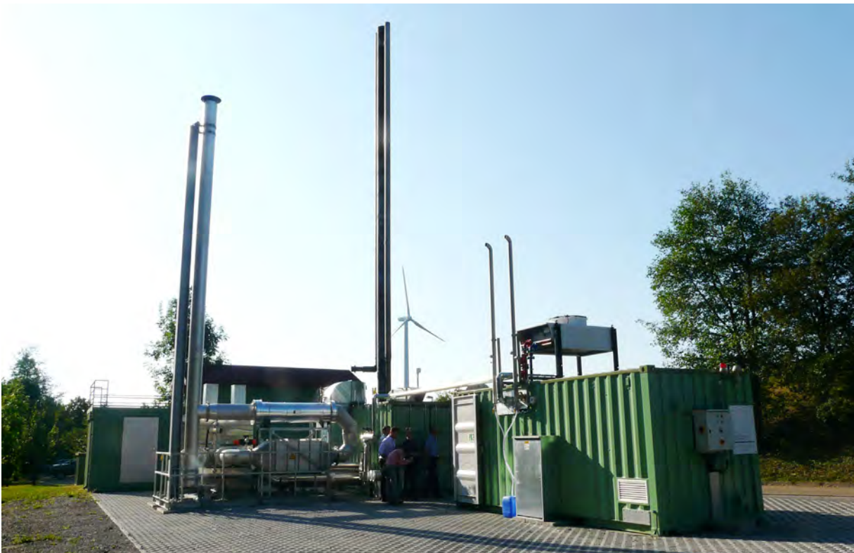
Entgasungsanlage einer Deponie
