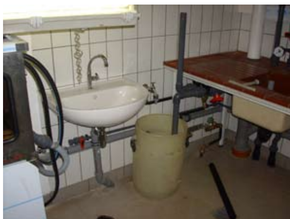
Abb. 154: Waschbecken und (Rück)Spülvorrichtung für die Messwasserleitung
