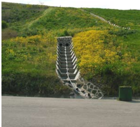
Abb. 48: Oberflächenwassergerinne auf der Deponie Gerolsheim (Foto K.Brand)
