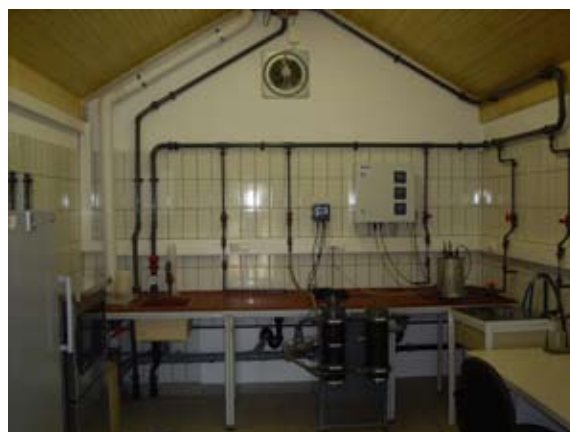
Abb. 156: Messeinrichtungen (Station in Betrieb)
