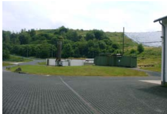
Abb. 49: Deponiegasmotor und Hochtemperaturfackel auf der Deponie Meudt (Foto K.Brand)
