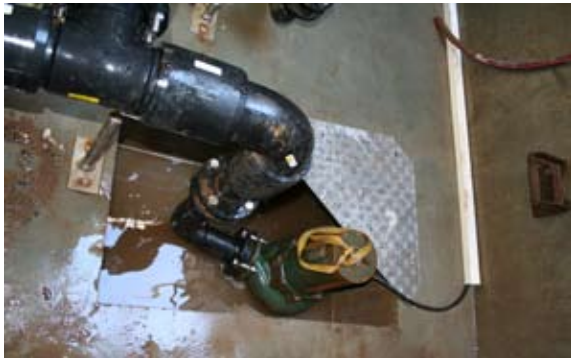
Abb. 168: Lenzpumpe im Pumpensumpf
