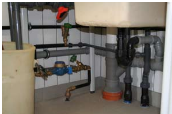
Abb. 153: Zu- und Ableitungen Messwasser, Abwasser und Trinkwasser unterhalb der Arbeitsplatte
