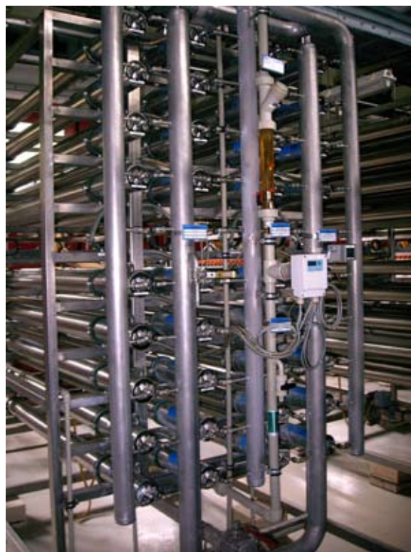
Abb. 50: Sickerwasserreinigungsanlage (Umkehrosmose) auf der Deponie Meudt (Foto K.Brand)
