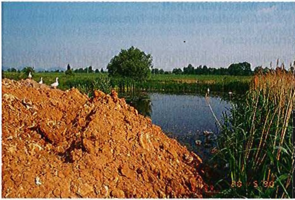
Foto 94. Verfüllung eines Gewässers im Zuge der Anlage eines Gewerbegebietes (Foto: G. KÜMMEL).-
