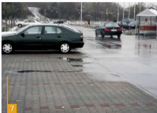
Versickerungsfähiges Pflaster auf dem Parkplatz des Baumarkts. Deutlich ist die Versickerung an den „Wasserspuren“ zu erkennen.
