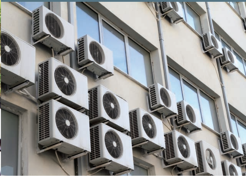
Klimaanlagen an einem Bürohaus
