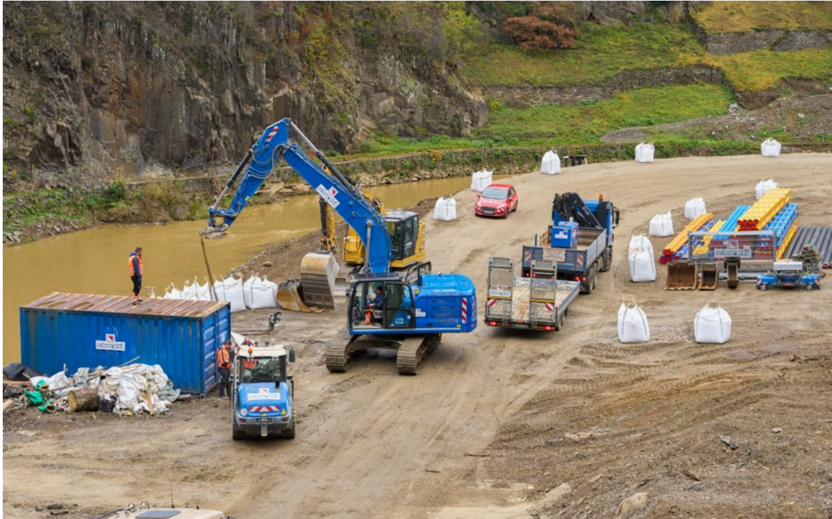
Die Straßeninfrastruktur wurde zerstört und muss neu errichtet werden. (Foto: Thomas Frey)
