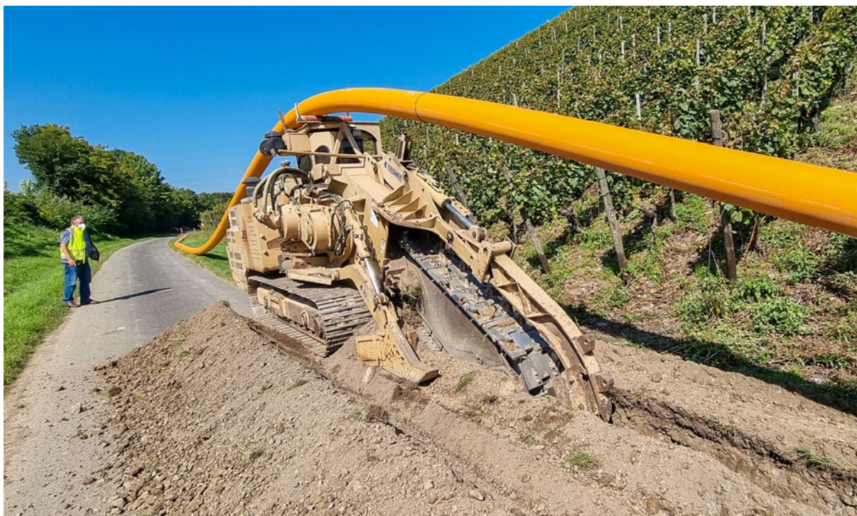
Bau der provisorischen Gas-Hochdruckleitung an den Weinbergen in Bad Neuenahr. (Foto: EVM)
