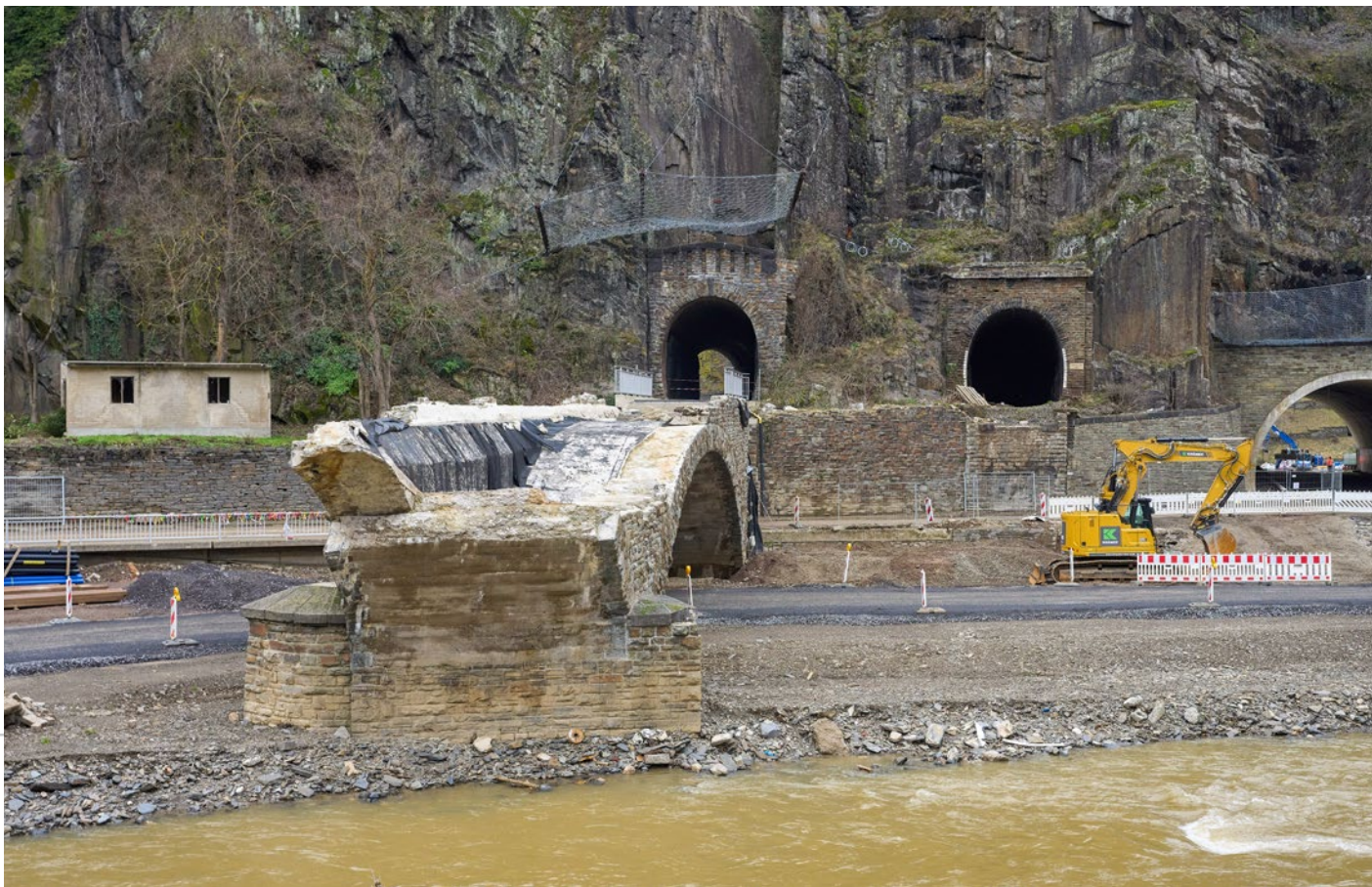
Die Verkehrsinfrastruktur – wie die historischen Bahnbrücken in Altenahr – ist vielerorts zerstört. (Foto: Frey)
