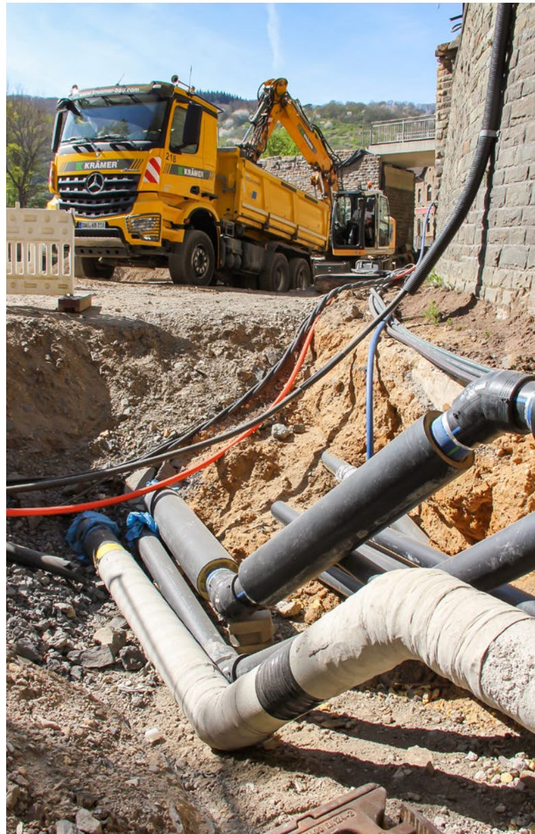
Deshalb werden die Versorgungsleitungen sicher und vor allem vernetzt geplant und verlegt. (Foto: Adams)
