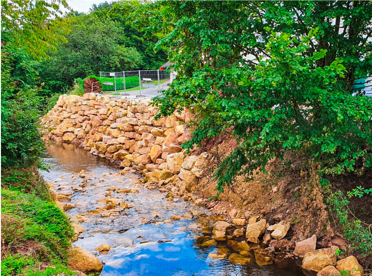
Am Kailbach wurde ein Ufer erst provisorisch, dann dauerhaft mit schwerem Stein gesichert. (Foto: Landkreis Bernkastel-Wittlich)
