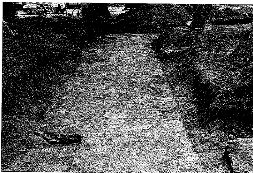
4 Seligenstadt. Ehemalige Synagoge. Detail der Ostwand mit Fundamentverbreiterung im Bereich der Thoranische (Foto: G. Weber).
