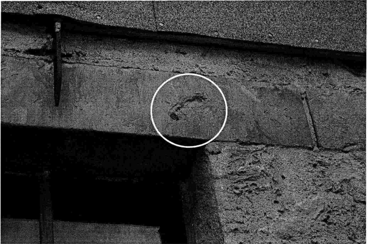
Zu sehen ist die Vertiefung der Mesusa, in der das Kästchen oder Röhrrchen angebracht und später wieder heraus gebrochen wurde.
