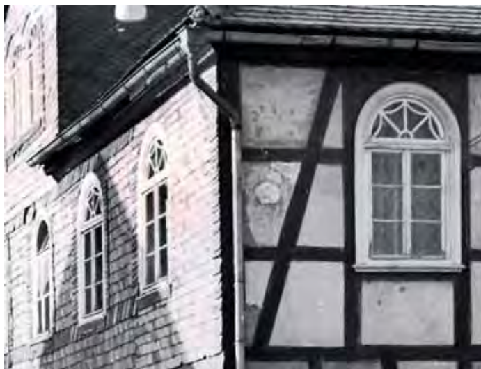
Detailaufnahme der Rundbogenfenster im oberen Stockwerk der ehemaligen Synagoge (Repro: Karl-Hermann Völker, Burgwald-Wiesenfeld)
