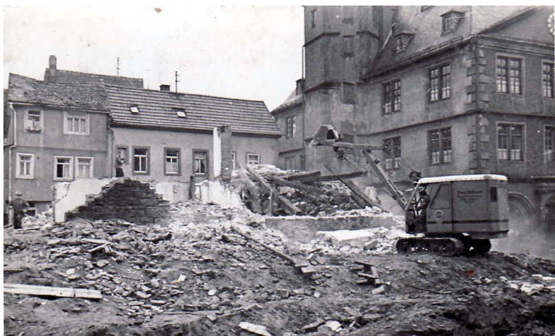
Abb. 21: Abbruch des Rothschildhauses, das 1938 im Wege der Arisierung in die Hand der Stadt Lohr a.Main kam und für den Neubau der Sparkasse zusammen mit Gasthaus „Zum schwarzen Adler“ abgebrochen wurde (Foto: Harth)
