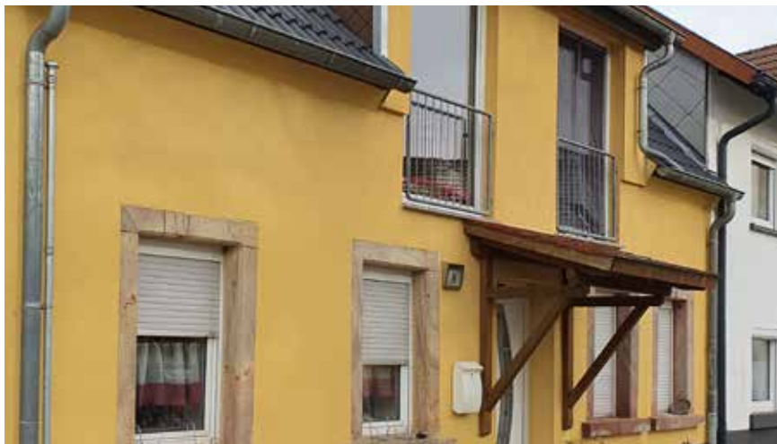
Gebäude mit geringem Sanierungsbedarf in der Ortsgemeinde Schallodenbach, VG Otterbach-Otterberg (Foto: Kernplan)
