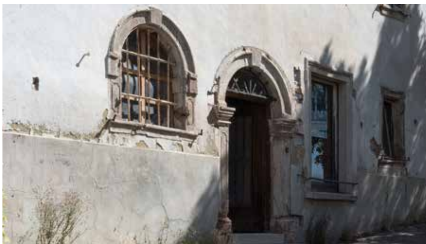
Gebäude mit hohem Sanierungsbedarf in der Ortsgemeinde Zellertal, Ortsteil Zell, VG Göllheim (Foto: Kernplan)
