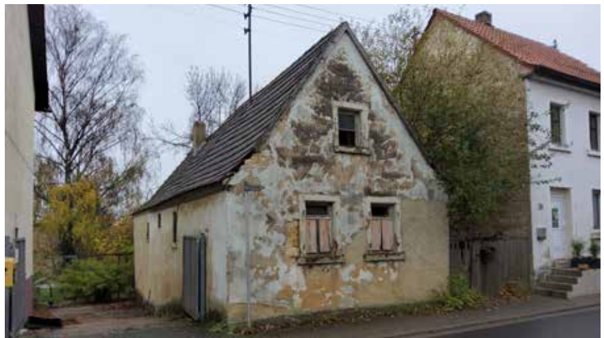
Leerstehende, stark sanierungsbedürftiges Gebäude in der Ortsgemeinde Rüßingen, VG Göllheim (Foto: Kernplan)
