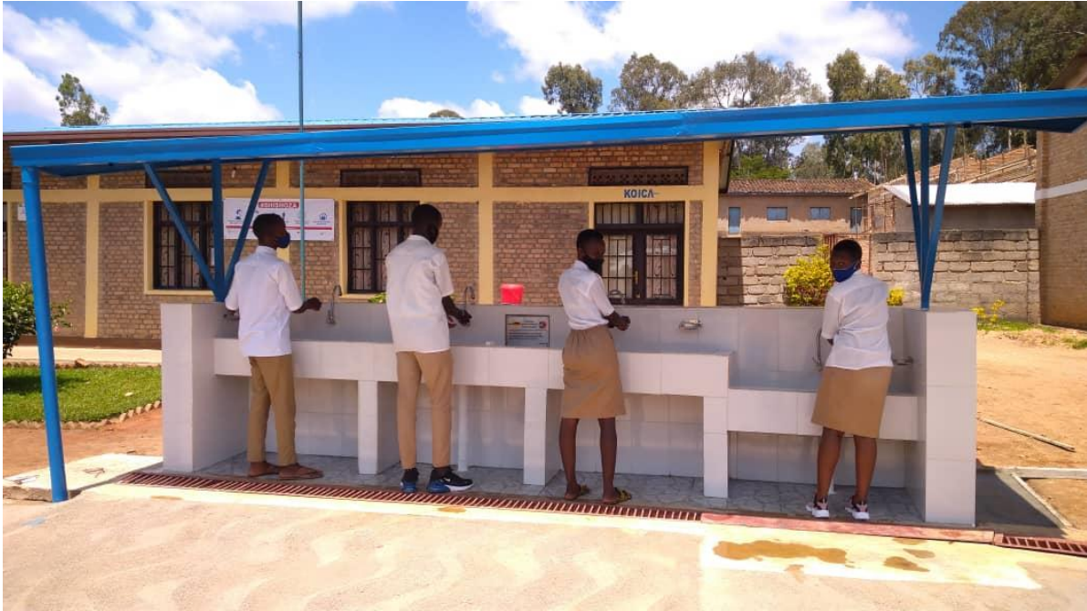
Abb.3: Eine der vielen Handwaschstationen, die an den Schulen notwendig wurden
