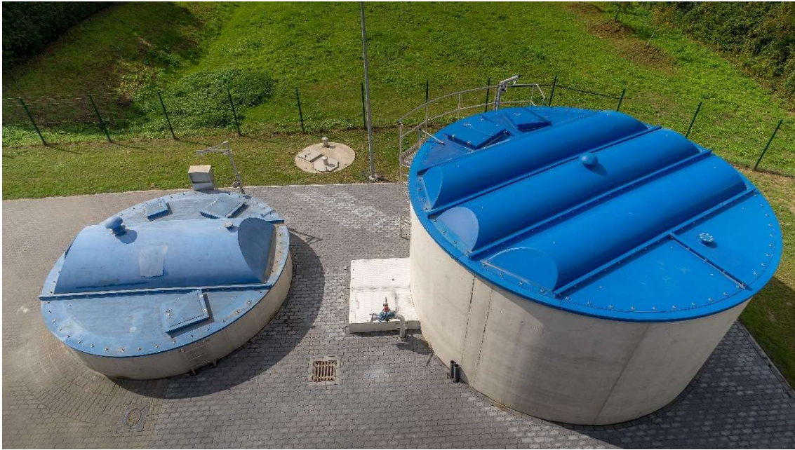
Abb. 10: Rohschlamm- und Fremdschlammannahmebehälter
